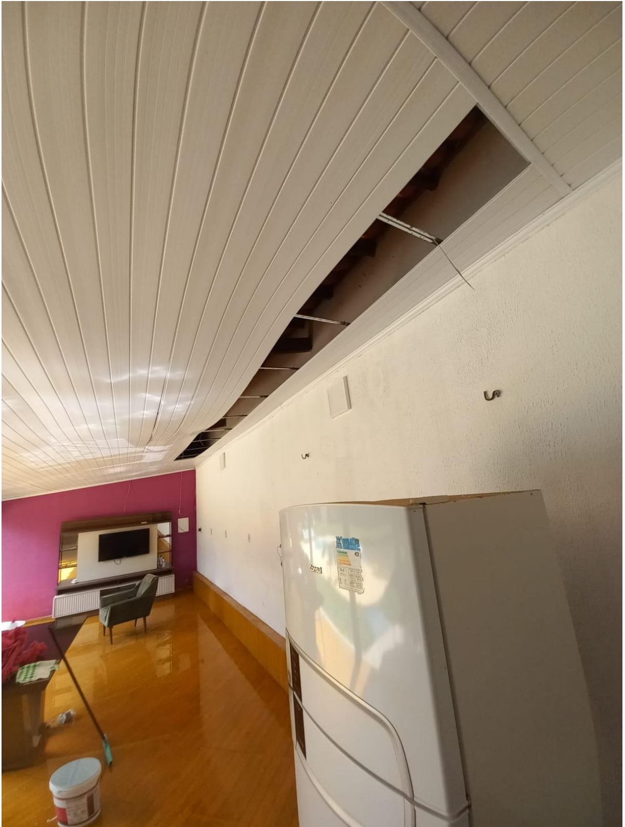
Foto 13 - Defeito no forro de PVC da cozinha aberta
