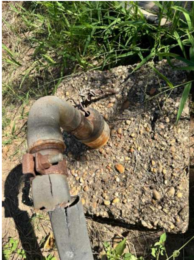
Poço artesiano sem manutenção e desativado
